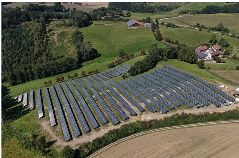
■ Abbildung 8: Beispiel Freiflächen-Photovoltaikanlage Sextlgrub 4
