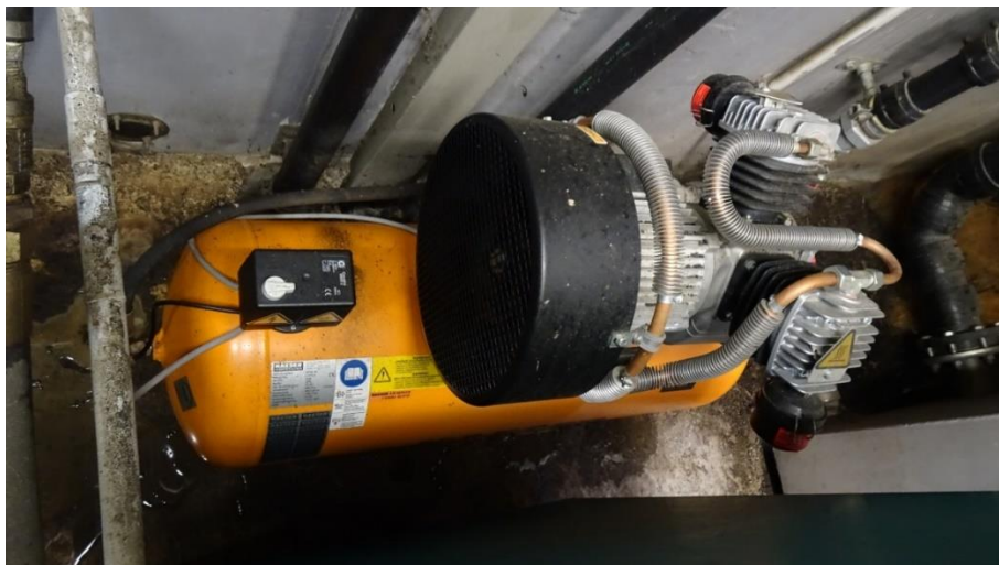
Abbildung 19: PW-Elnrode-Strang: Druckluftversorgung für die pneumatischen Antriebe
