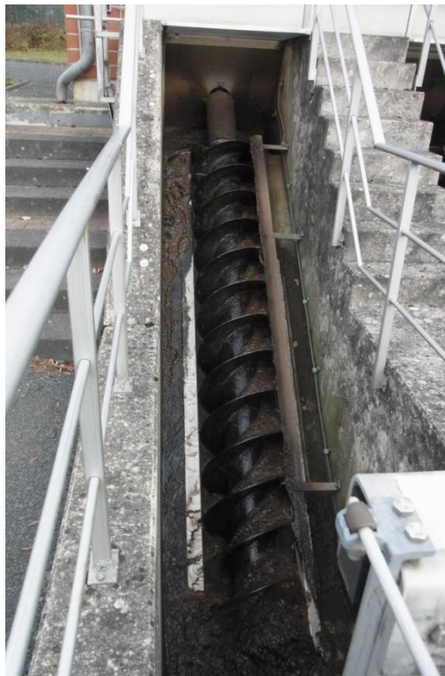
Abbildung 6: Rücklaufschlammumpwerk der Biologie
